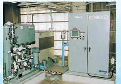
▲再生水プラント(酸素発生機とオゾン発生機)
