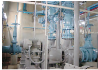
▲調整池返送水ポンプ
