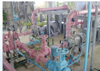
▲汚泥圧送ポンプ
