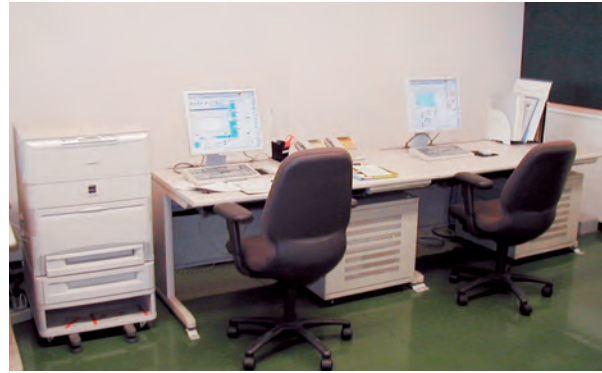
中央監視室 Central Control Room
