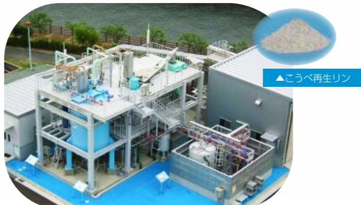
▲リン回収設備
