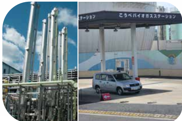
▲バイオガス精製設備 ▲こうべバイオガスステーション
