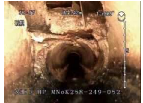
汚水管渠の老朽化
