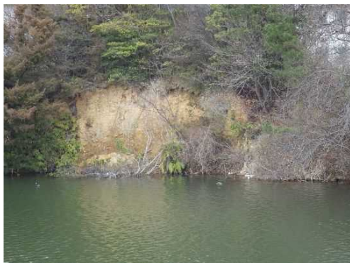
ため池周囲 土砂崩壊
