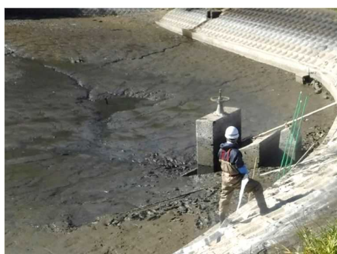
泥土堆積状況(かいぼり実施前)
