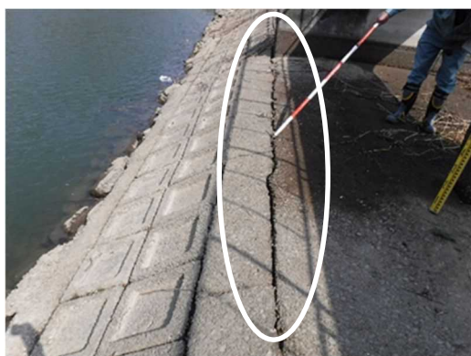
洪水吐流入部 ひび割れ
