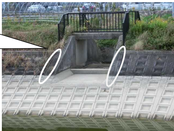
洪水吐(貯水池側より)
