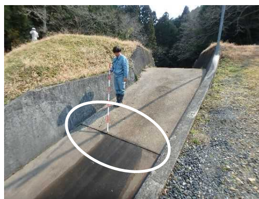
放水路部 漏水
