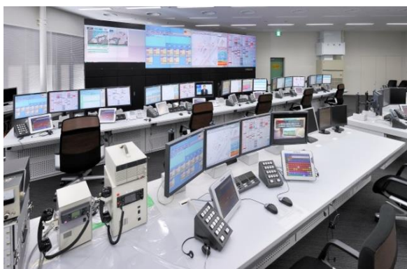
消防管制室の状況
