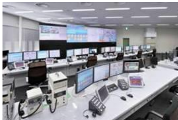
消防管制システム
