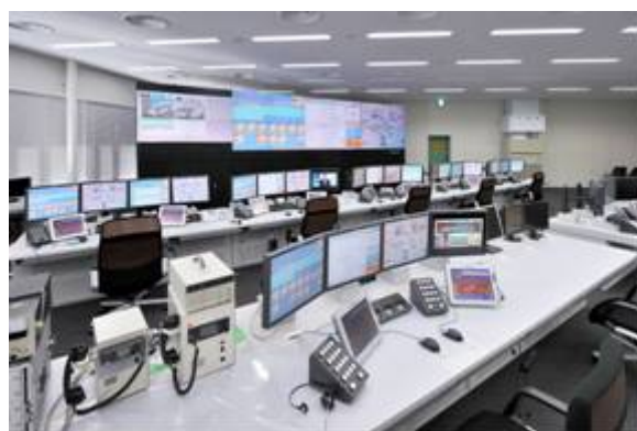
消防新管制システム (ALT-FACE)
