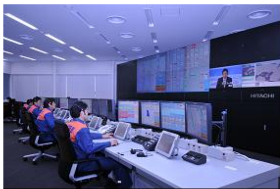
消防管制室の状況
