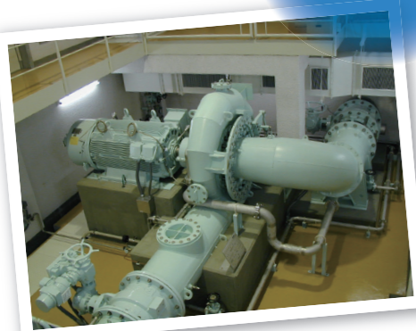
小水力発電(180kW) 神戸市水道局 千苅浄水場
